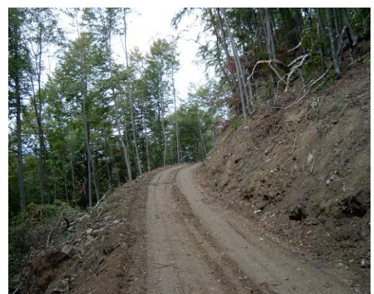
Scarpate da consolidare
